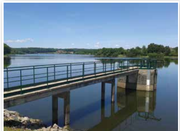
— Prise d'eau dans une retenue superficielle —
