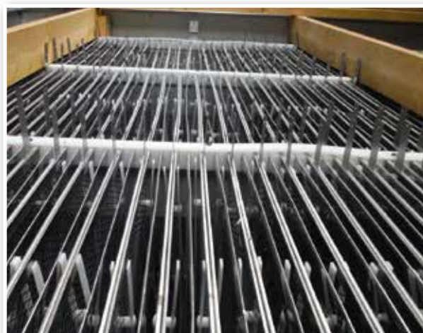
— Détail d'une unité d'électro-décarbonatation —
