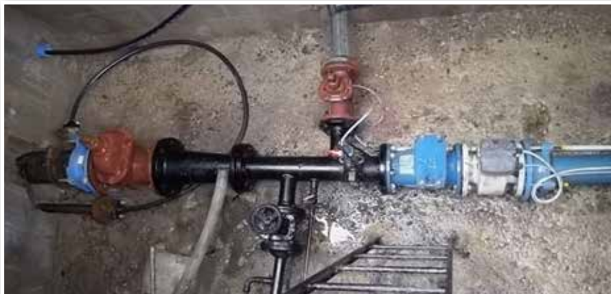
Organe de comptage sur un réseau
