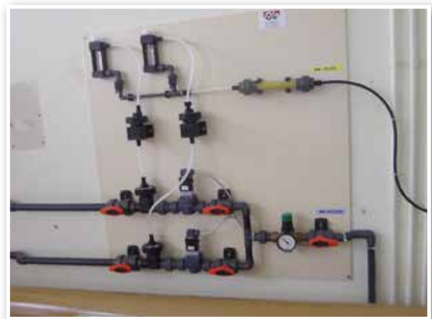
Unité de chloration
