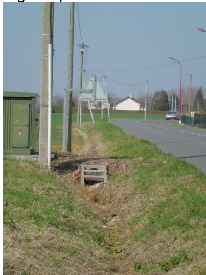
Fossé doté d'une buse installée par un concessionnaire (avec autorisation préalable) pour accès à un poteau.
